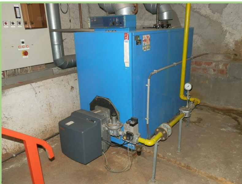
Georg-August-Zinn-Schule / Heizraum Altbau
