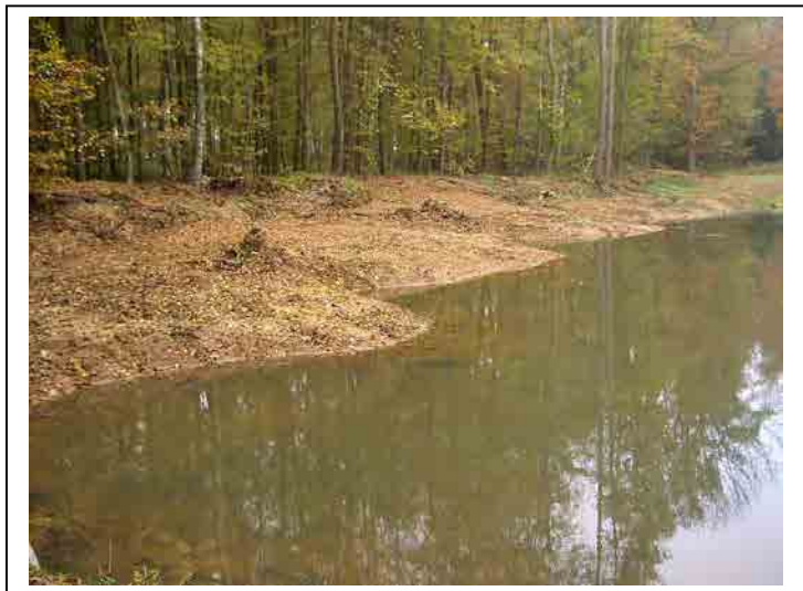
Bild: Der undichte Damm des unteren Teichs wurde neu aufgebaut (links), die Uferlinie wurde in weiten Bereichen abgeflacht und neu profiliert
